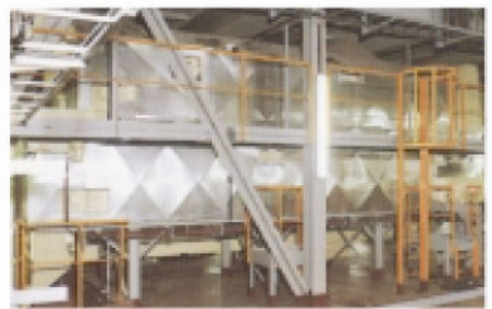
▲ الصورة توضح مجفف كال في محطة لتوليد الطاقة.
